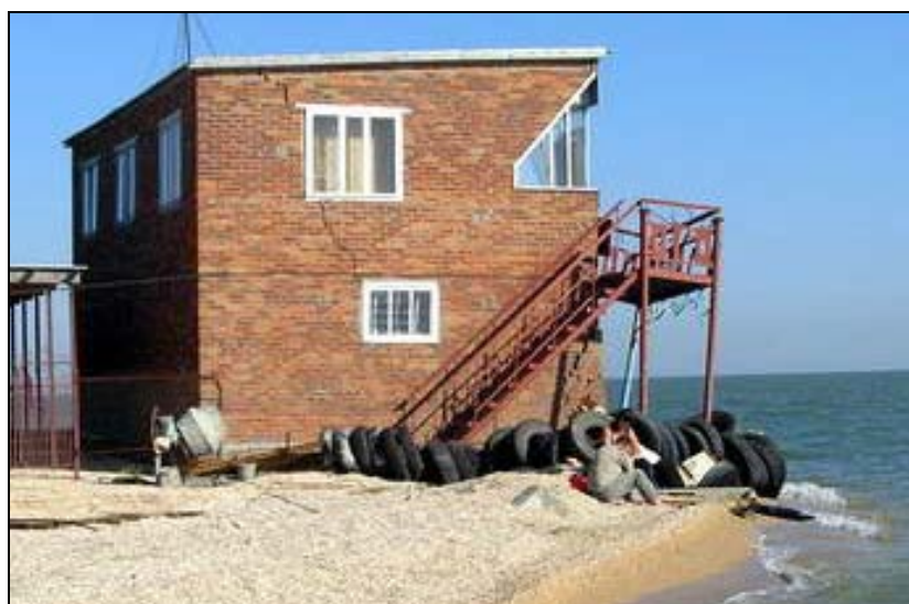
Рисунок 7.21 – Размыв берега привел к разрушению здания (Фото Крыленко М.В)
