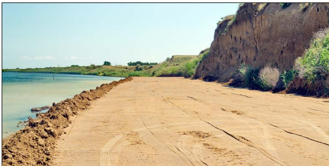
Рисунок 10.97 – Вверху – берег в ст. Тамань до начала берегоукрепления (фото Пешкова В.М.); внизу – отсыпка набережной в 2012 г. (фото Пешкова В.М.)
